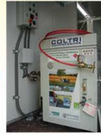
3. ระบบเพิ่มแรงดัน 200 barg
